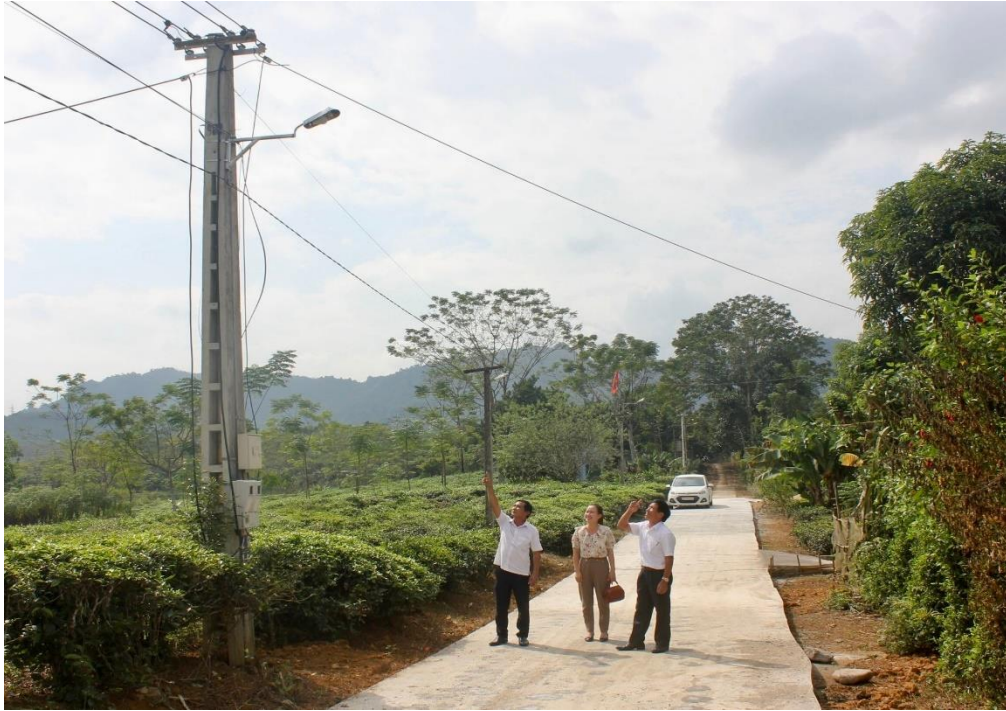
Tuyến đường bê tông và công trình thấp sáng đường quê thôn Sơn Thủy, xã Yên Thuận (Hàm Yên) mới hoàn thiện, giúp người dân đi lại và thông thương hàng hoá thuận lợi
